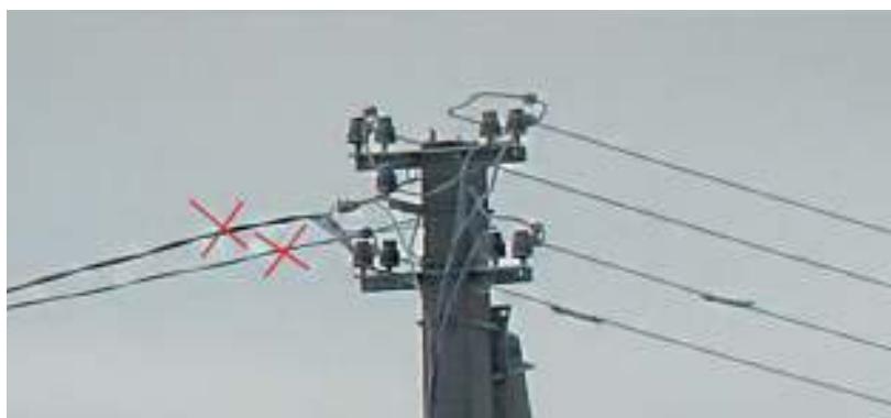
73 pav. Elektros įvado laidų kirpimo vietos
